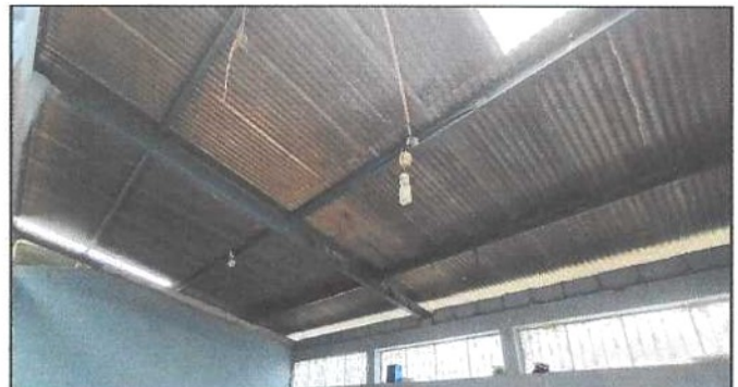
Mantenimiento de estructura metálica en área de aulas, debido a que presentan corrosión.
