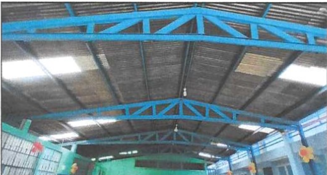
Foto 3: Mantenimiento de Estructura metálica debido a que presenta corrosión en alguna partes.
