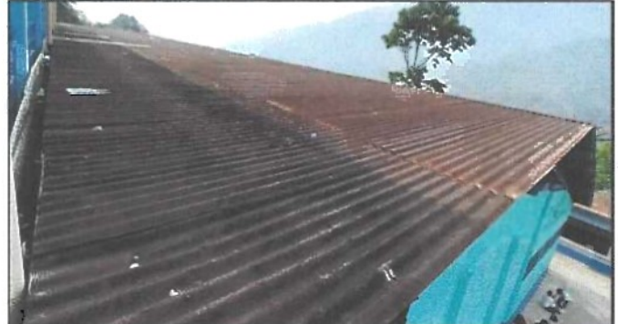
Foto 2: Sustitución de láminas por deterioro por el paso del tiempo, imagen parcial de donde se localiza el salón de usos múltiples.
