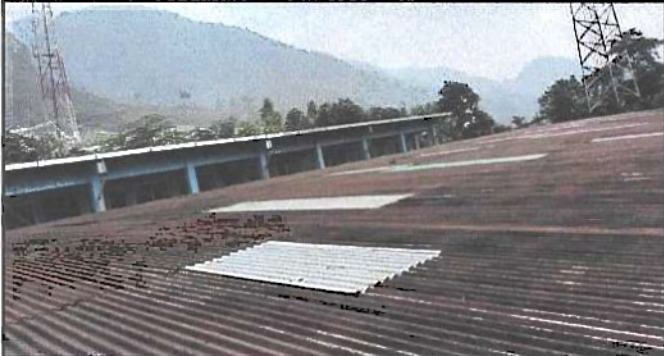
Foto1: Sustitución de lámina por deterioro, imagen parcial de donde se localizan aulas, dirección y parte del salón de usos múltiples.
