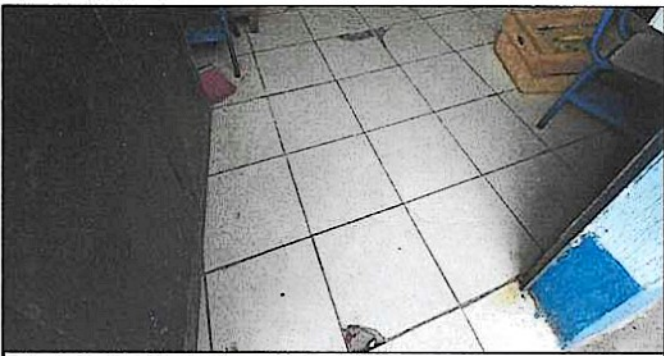
Foto 4: Sustitución de piso cerámico debido a que el que se encuentra instalado se encuentra deteriorado.
